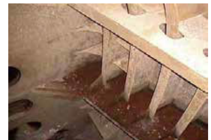
バラストタンク:38ヶ月後の状態
