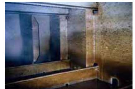
バラストタンク:15ヶ月後の状態
