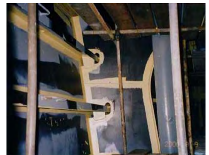
裸露钢板施涂了Interbond®808的修补涂层，边缘处进行了一次预涂装
