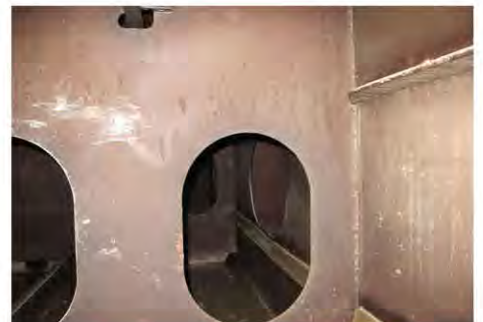
非常好的性能-化学品船运营9年后的压载水舱
