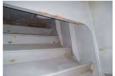
良好的状态-运营5年后的焊缝和锐角
